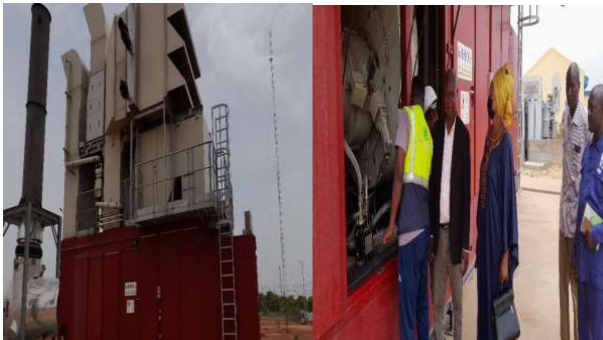
Turbine à Gaz de la centrale électrique de Moundou
